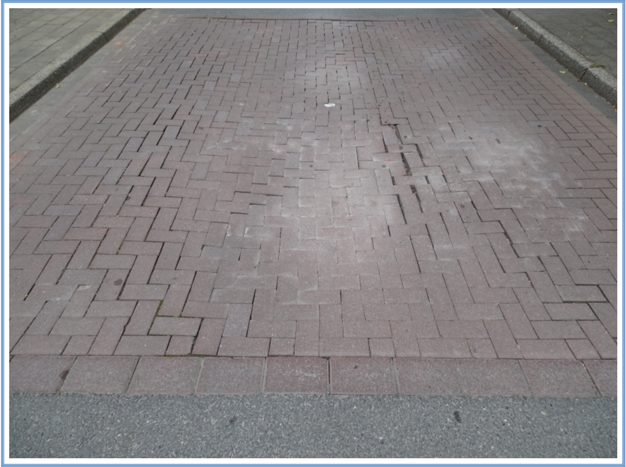
Bild: Die verformte Pflasterfläche im Bereich Lipperstraße 67.
